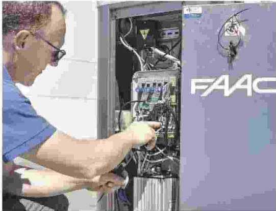
Un manutentore di un cancello automatico della Faac di Bologna
